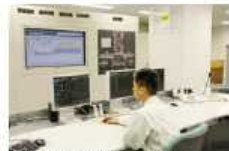
日々変わるデータが集約される中央監視室
